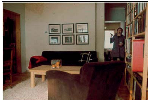
Vasemmalla, olohuoneen nurkassa oli tapahtunut runsas vesivuoto. Se oli ilmeisesti peräisin vintillä olleesta ruostuneesta paisuntasäiliöstä. Oikealla näkyvän kirjahyllyn takainen seinä on vasemmanpuoleisessa kuvassa purettu.
