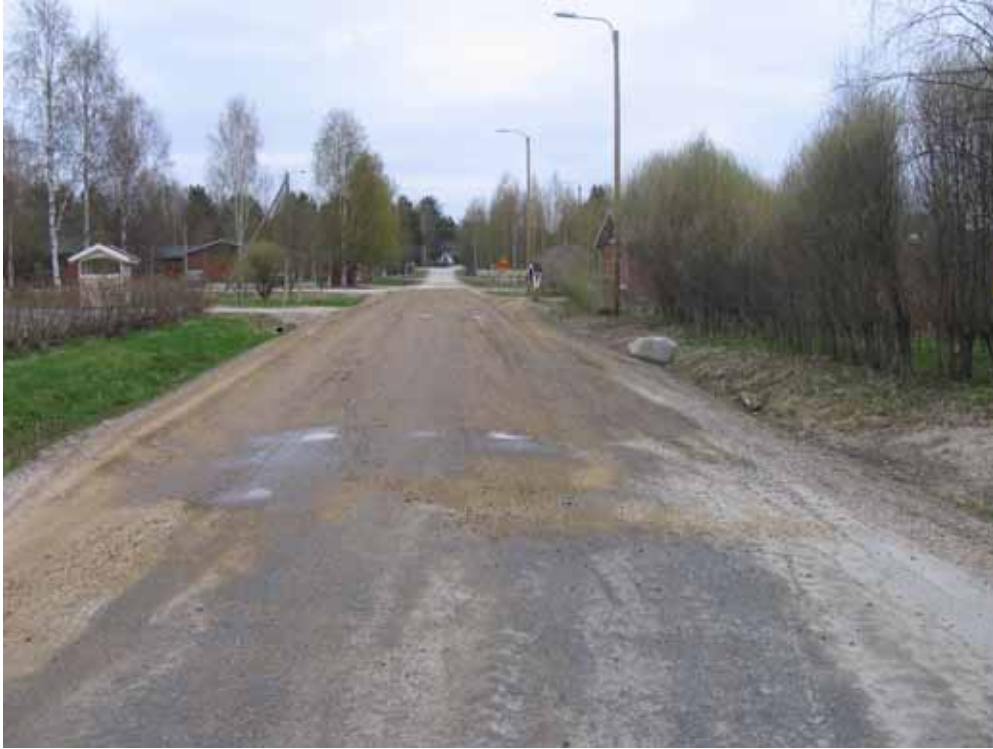
Kuva 35. Paulintieltä puuttuu kevyen liikenteen väylä.
