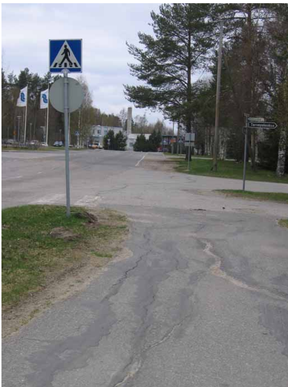
Kuva 37. Aimontien ja Kokkokalliontien liittymien väliltä puuttuu kevyen liikenteen väylä. Olemassa olevalla väylällä on pahoja routavaurioita.
