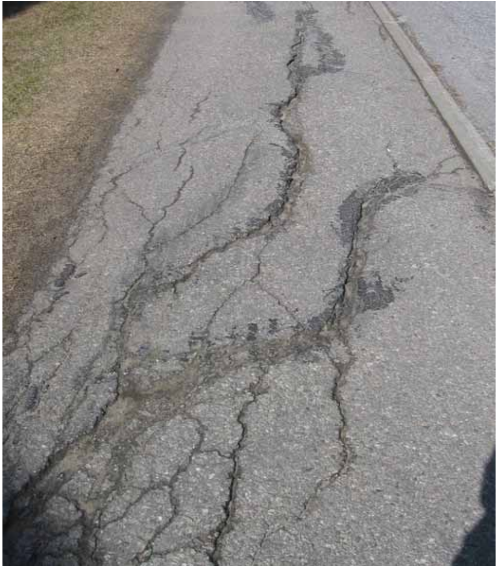
Kuva 29. Kuntalaisten Talon kohdan kevyen liikenteen väylällä olevia päällystevaurioita.
