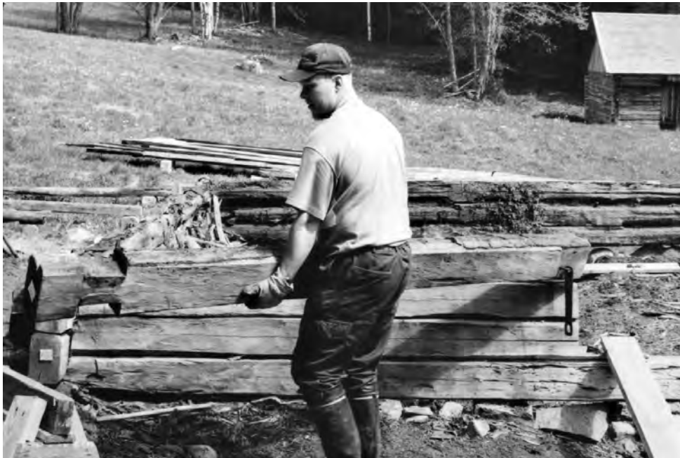
Vanhan pihaton purkutöitä. Valokuvaan on merkitty vuosi 1995, mutta kyseessä lienee vuosi 1999. Kalervo Virkki.
