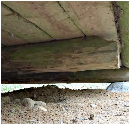
Vuoden 1995 kunnostuksessa lattiaan asennettu niska poistettiin vuonna 2020. Niskan poiston seurauksena lattiamalat notkuvat kiusallisen paljon.
