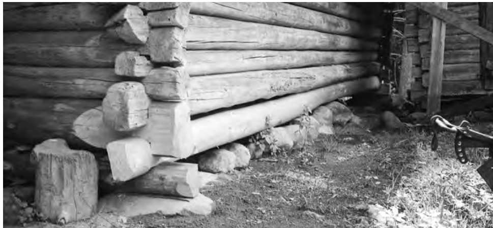
Pihattoladon luoteissivun alin hirsi uusittiin haapana ja koillissivun alin hirsi kelona vuonna 1997. RHO 118579, MV, pääarkisto.
