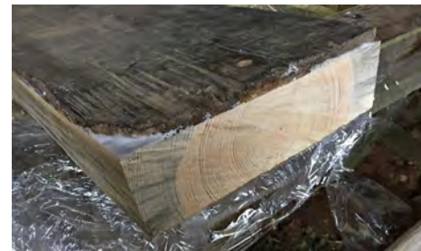
Luoteissivun reunimmaisista lattialankuista säästyi vain ohut pintaosa. Marraskuu 2015.
