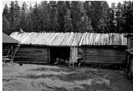
Vuoden 2000 vesikatto tehtiin konehalotuista maloista. Työtä säästy, mutta malat kiertyivät liikaa sekä ulkonäön että toimivuuden puolesta. Vasen kuva Raimo Autio, 2000.
