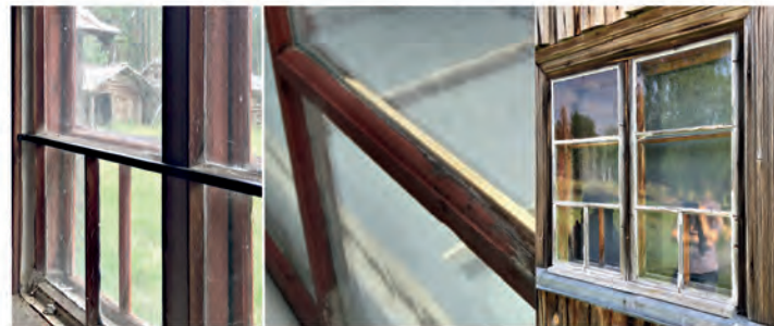
Lounaissäädyn uusittavissa lasiurapuitteissa on koristeellinen profiili. Oikeanpuoleisessa kuvassa lounaissäädyn nykyiset puitteet, jotka ovat ikkunan vanhat sisätuplat. Sisätuplat varastoidaan samaan koteloon ulkopuutteiden jäänteiden kanssa.
