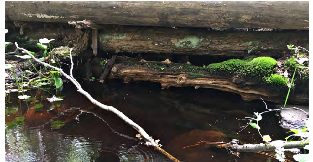
Sillan alla näyttäisi olevan yhden tai jopa kahden vanhemman sillan jäänteitä. Jäänteet saattaisivat olla peräisin vuoden 1974 valokuvassa näkyvän sillan kaltaisesta rakenteesta. 2018.
