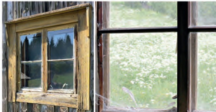
Koillispäädyn ikkuna. Tarjouspyyntö koskee kahta kitillä lasitettua ulkopuutetta, joista toinen on varustettu sarakoilla ja sormihailla. Puitteet kunnostetaan ja käsitellään pellavaöljymaalilla.
