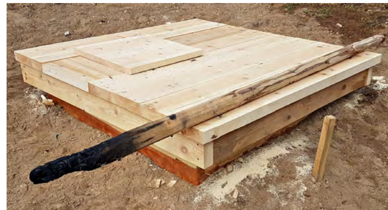
Kaivo valmiina kannen kahvaa ja tolpan pystytystä lukuun ottamatta. Risto Holopainen, Lintukorpi Oy, 2019.
