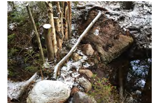
Vuonna 2017 tehty alapellon ojan pato.
