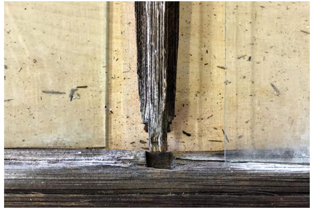
Ulkopuitteen pystyvälipuite ennen korjausta.
