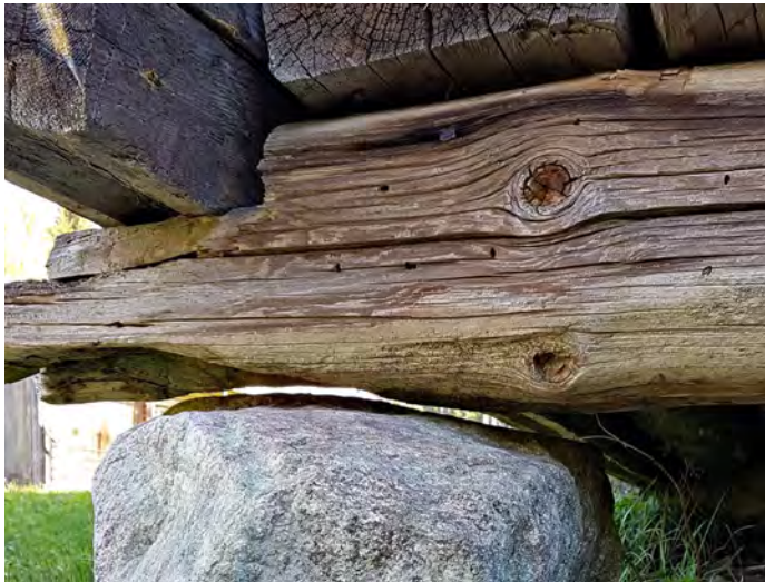
Riihen lounaissivun keskimäinen perustuskivi ei ollut painunut lainkaan, jolloin länsinurkka oli noussut kiveiltään. Kesäkuu 2020. Lintukorpi Oy.
