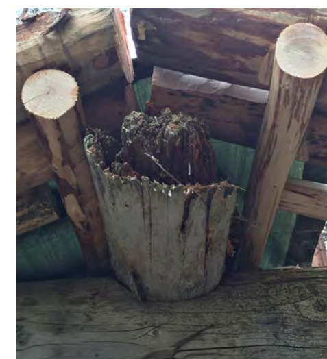
Päätyräystästä huhtikuussa 2018. Räystäälle on asennettu apuvuoliaisia, jotta alusmalat saisivat paremman tuen ja vuoliaisten päät saataisiin sateen suojaan.
