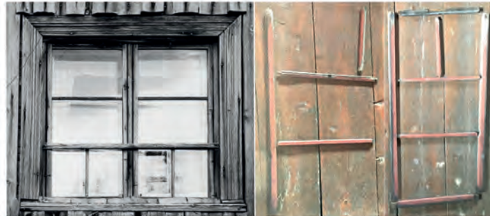
Lounaissäädyn ikkuna. Tarjouspyyntö koskee kahta lasiurallista ikkunanpuutetta. Vasemmalla ikkuna tukipuineen vuonna 1974 ja oikealla ikkunan jäänteet. Puitteista tehdään kopiot, jotka maalataan sisäpuolelle näkyviltä osiltaan pellavaöljymaalilla. Vanhoille puitteille tehdään kotelo.
