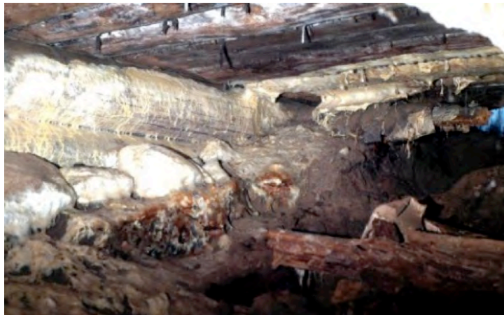
Lattiasienen valtaama alapohjarakenne vuonna 1980. Panu Kaila.
