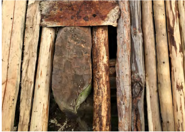
Aluskatteen yläpinta samassa tasossa päätykolmioiden yläpinnan kanssa. Tuohien tuenta räystäällä päätykolmion kohdalla ratkaistaan tapauskohtaisesti. 2018
