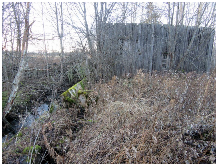
Myllyn toisessa päässä on sijainnut saha. Ilmeisesti osa myöhemmistä betonirakenteista liittyy myös siihen. Kuva länteen.
