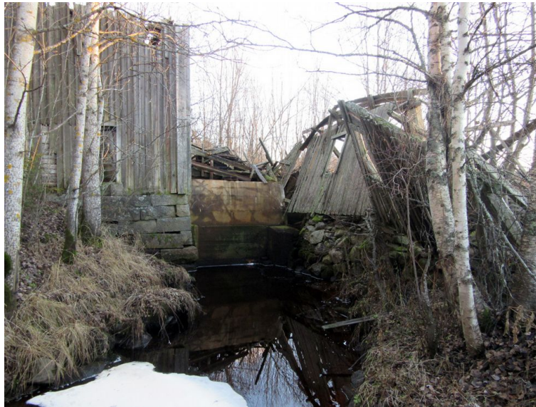
Myllyn kanavaa ja romahtanut myllyrakennus. Kanavan vanhimmat osat ovat 1800-luvulta. Kuva etelään.
