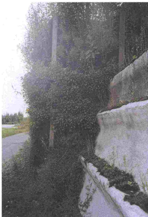
Kuva 24. Kaukasian pitkäpalkoa oli runsaasti vesitornissa elokuussa 1998. Betonimuurissa oli sammalta.
