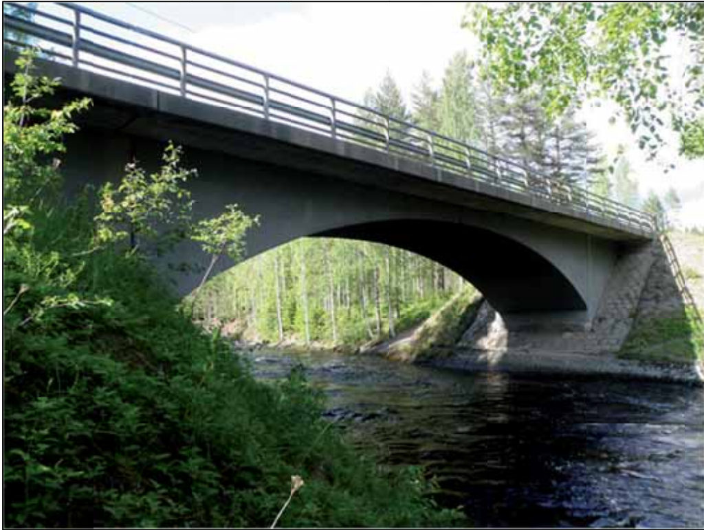
Kuva 2-5. Vuonna 1978 rakennettu Lastukosken silta S-196, joka on tyypiltään teräsbetoninen holvisilta. Yleistarkastuksen 2010 perusteella sillan kuntoluokka on 3 (tyydyttävä). Sillan vesieristystä ja kaiteiden kiinnitystä on tarpeen lähiaikoina korjata.
