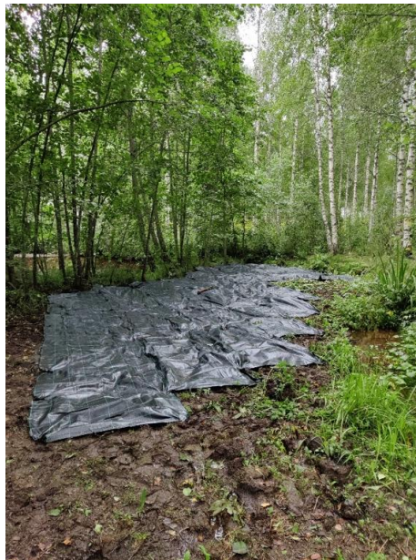
Talkoissa 9.8.2021 laitettiin noin 100 m 2 katekangasta. Kate kiilattiin hyvin ja lisäksi katteen päälle laitettiin vettyneitä puunrunkoja. Kuva: Jari Kiljunen / SLL Viekas LIFE
